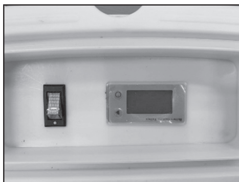
ภาพที่ 6 การติดตั้งสวิตช์ไฟ AC และหน้าจอแสดงระยะเวลาการใช้งานของแบตเตอรี่
