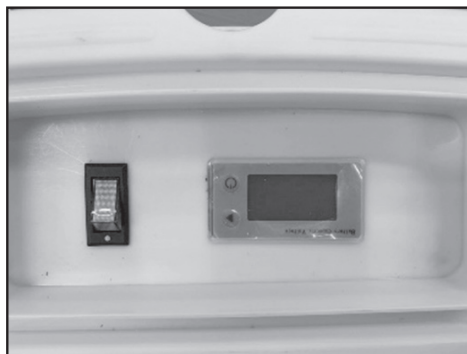
ภาพที่ 6 การติดตั้งสวิตช์ไฟ AC และหน้าจอแสดงระยะเวลาการใช้งานของแบตเตอรี่
